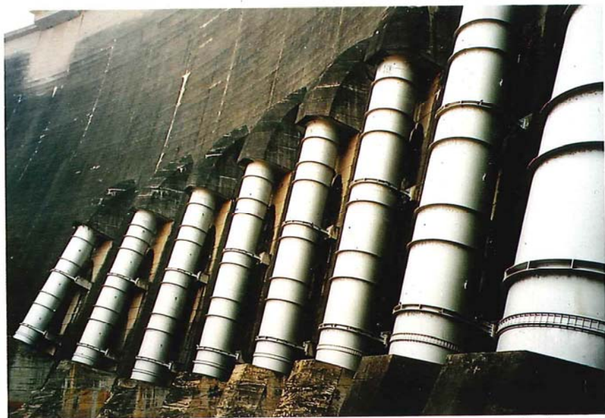
ท่อส่งน้ำโรงไฟฟ้าพลังน้ำเขื่อนภูมิพล
