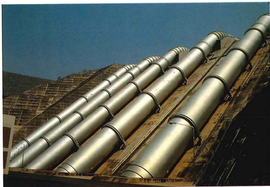
ท่อส่งน้ำโรงไฟฟ้าพลังน้ำเขื่อนศรีนครินทร์
